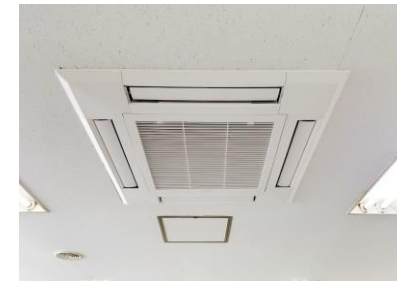
天井埋込型エアコン2台付 2023.5 設置
