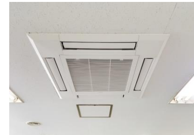
天井埋込型エアコン2台付 2023.5 設置
